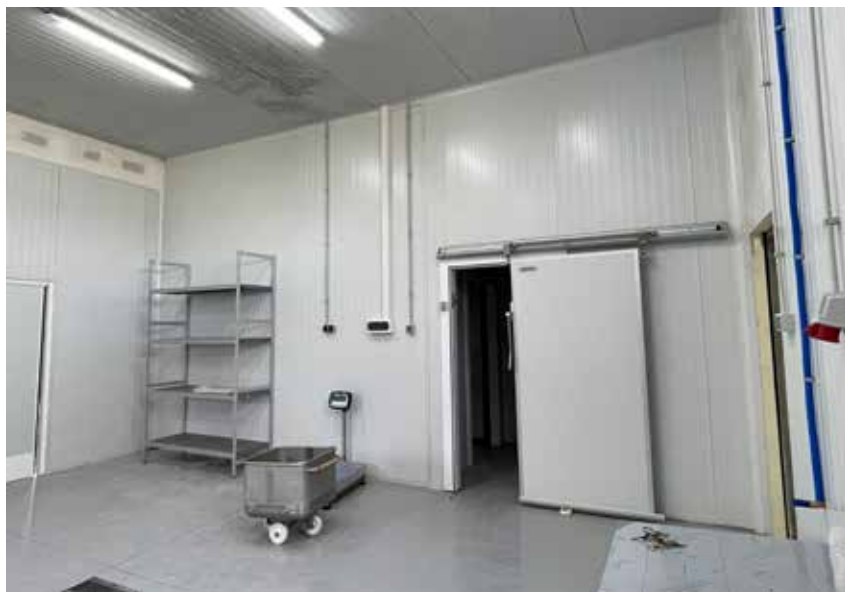
Las instalaciones disponen de cámaras frigoríficas para la conservación de productos.
